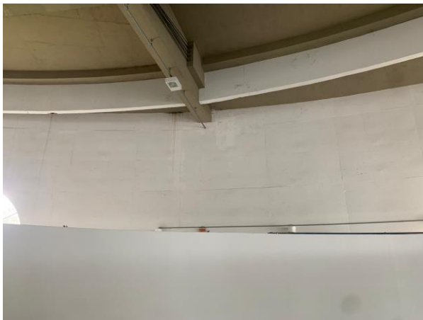
FIGURA 1: Rebocos desprendidos, trincas e fissuras.
