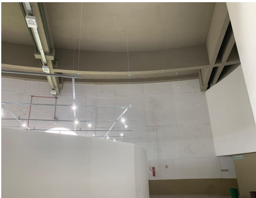
FIGURA 5: Trincas e fissuras.
