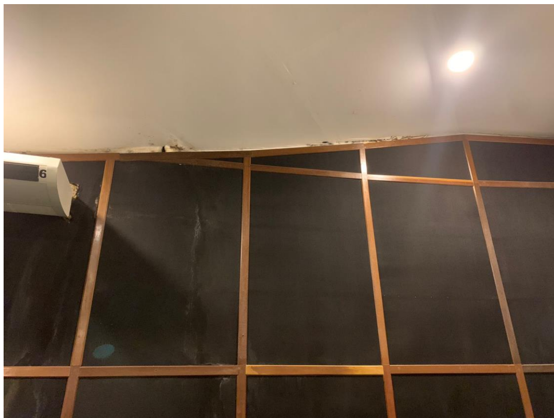
FIGURA 6: Rebocos desprendidos e mofos
