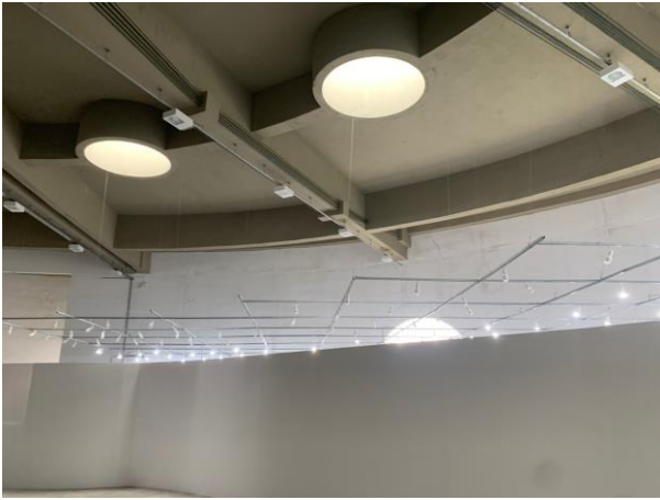
FIGURA 2: Rebocos desprendidos, trincas e fissuras.
